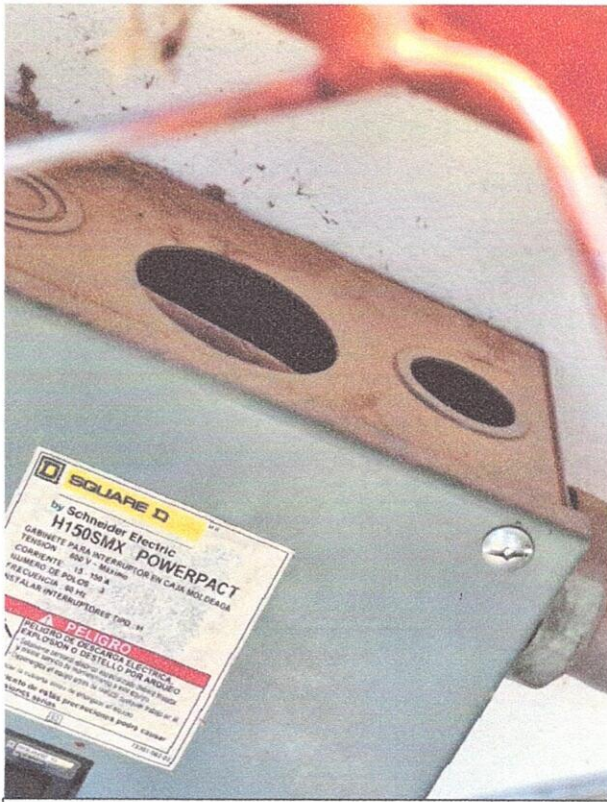
NC 2.- Tiene hueco en el gabinete
