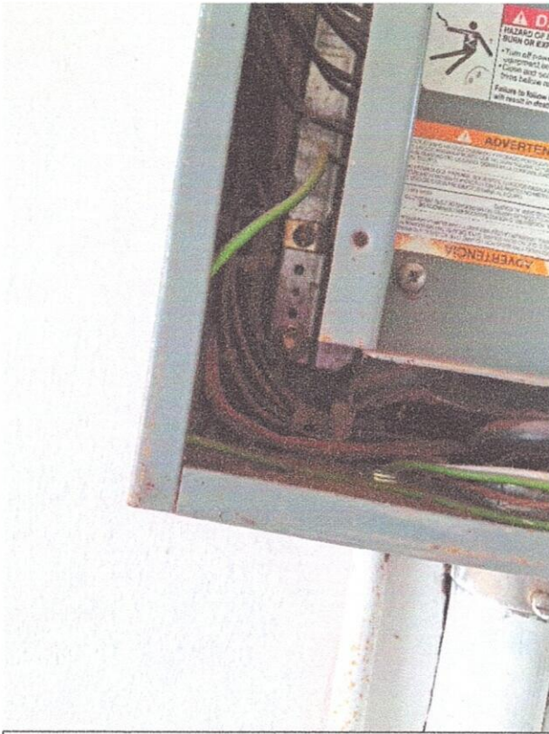
NC 1.- No está puesto a tierra el gabinete
